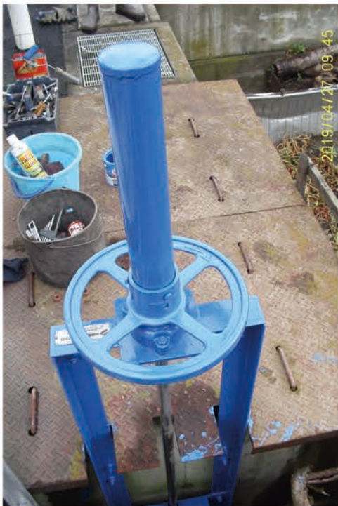
山崎の交差点近く、笠原落川にある水門（中島水門） この水門は鈴木鉄工所が手掛けており、毎年田植え の時期になると、現地に行って作業するそうです。
